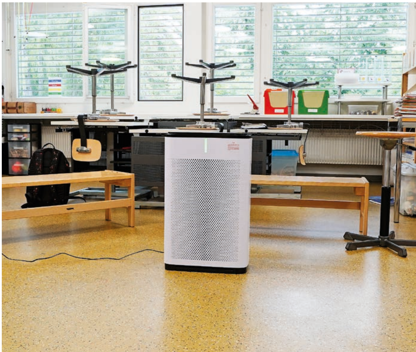
In der Primarschule Zumikon steht in jedem Klassenzimmer ein Luftreinigungsgerät.
